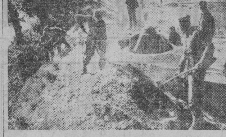
Hombres del Servicio de Trabajo camuflando un "Bunker" que acaba de construirse en la costa mediterránea del frente alemán.
