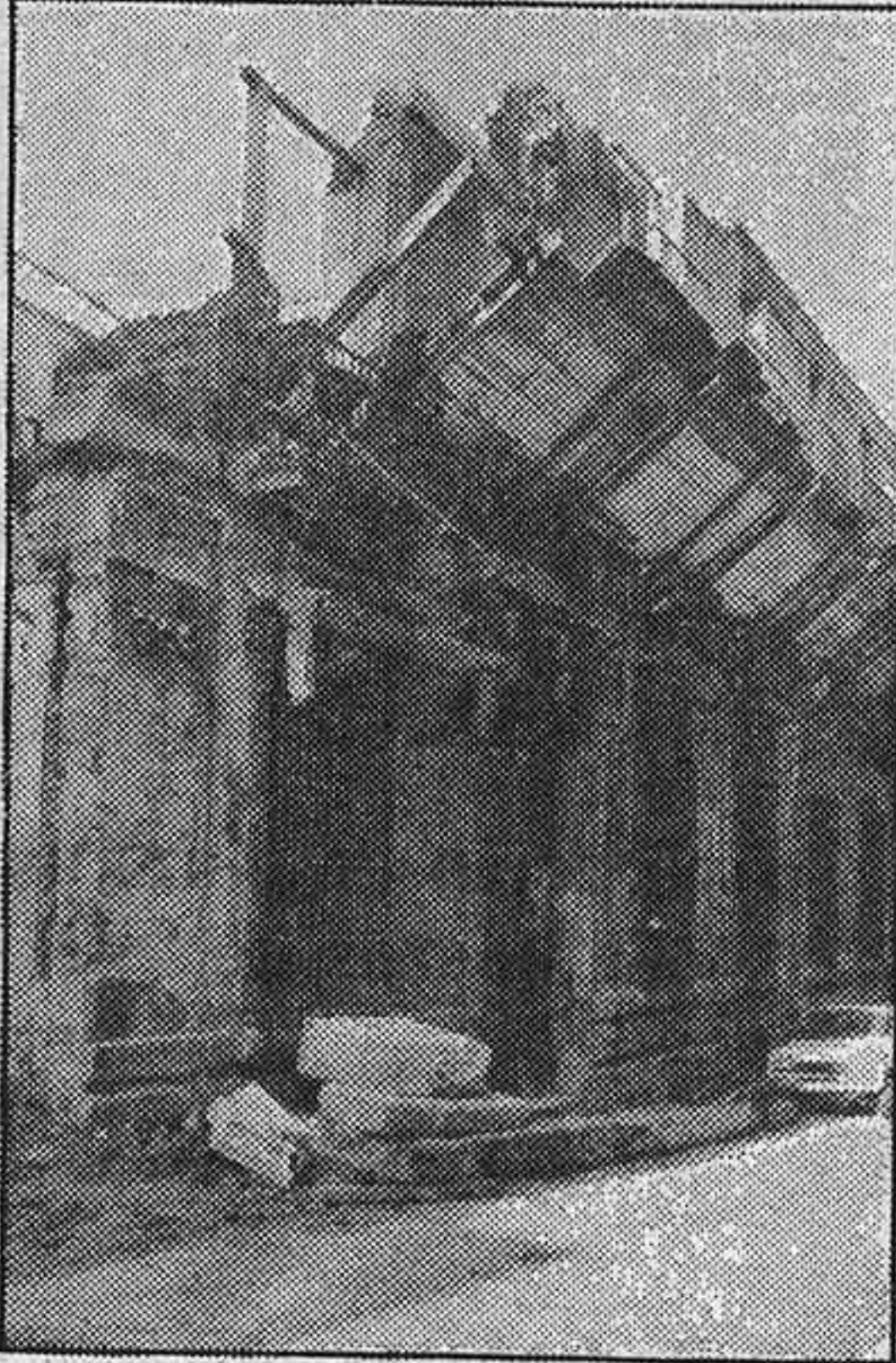
Palacetes como este de la calle de la Luna ofrecían hace cuatro años este deplorable aspecto. El escudo de Talara aún permanecía intacto
