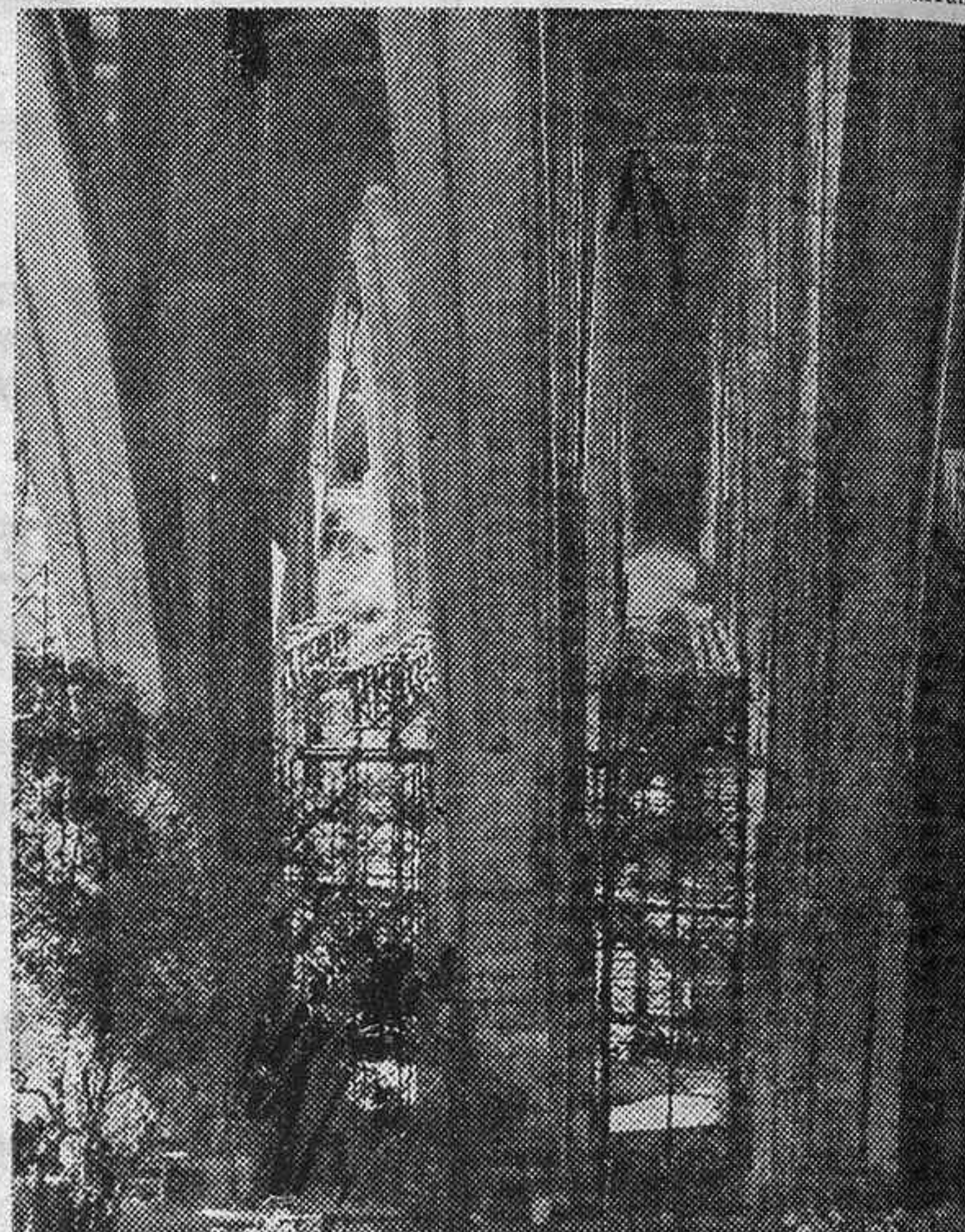
La parte inferior del Viaducto en sentido longitudinal. Desde el andamiaje metálico se operará la reparación del tablero de calzada, de abajo arriba. (Torremocha.)
