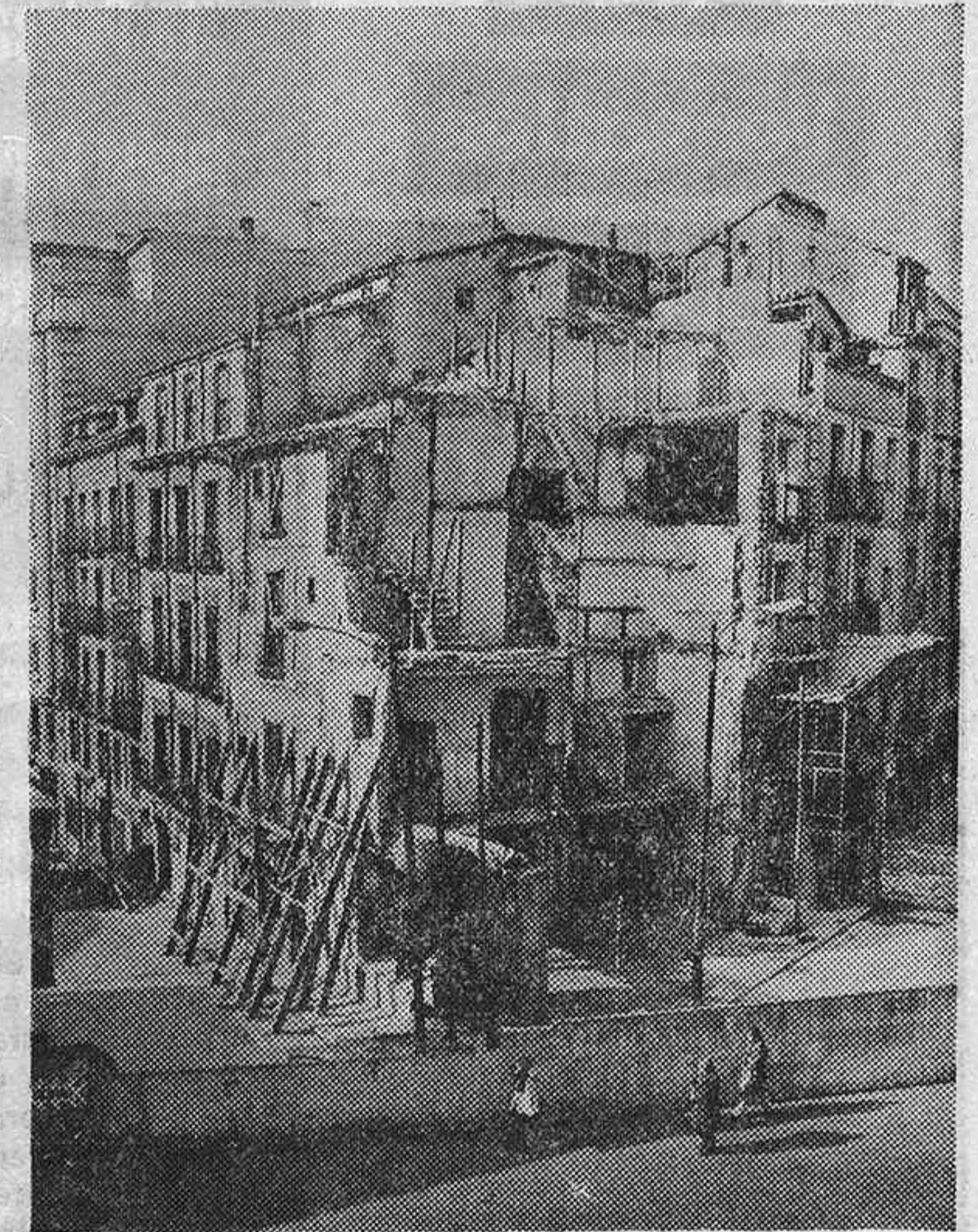
Esta es la casa número 1 de la plaza de Santo Domingo, en trance de derribo, y cuya ruina y apuntalamiento viene complicando hace un año el tráfico rodado de la encrucijada al anularse el de la calzada derecha de la Cuesta. En el solar resultante será construido un edificio en torre de catorce pisos. El derribo, en avanzada marcha, parece marcar la última etapa en la decisión municipal de una reforma definitiva de la antigua plaza.
