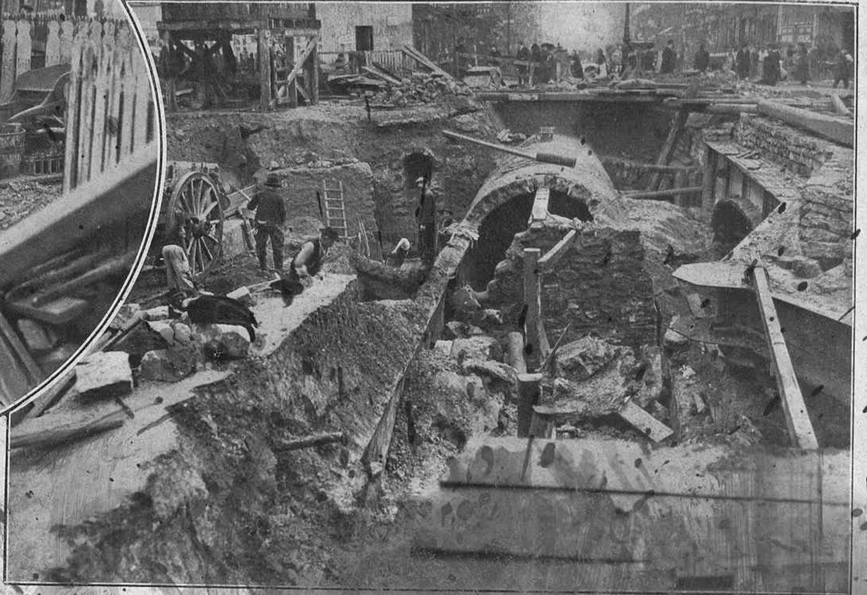
Vista de las obras en construcción del Metropolitano, destruidas por las aguas. En primer término se ve el túnel de la línea Norte-Sur que bordea la estación de San Lazaro. (Fotografías de Branger.)
