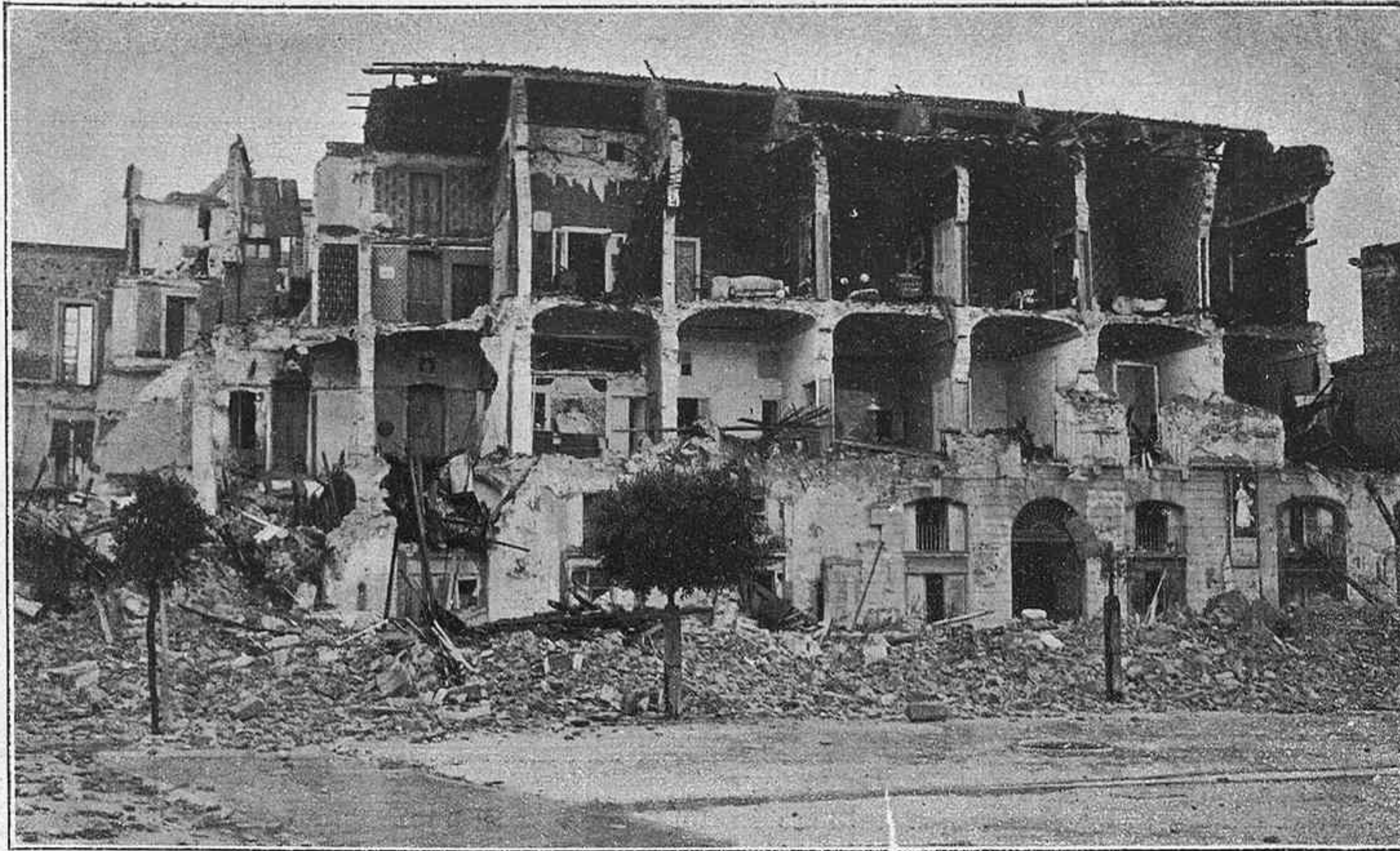
Mesina.—Casa destruida por el terremoto; una mitad fué reducida á escombros, la otra mitad quedó en pie. (De fotografía de Menasci-Dubois, remitida por Carlos Trampus.)
