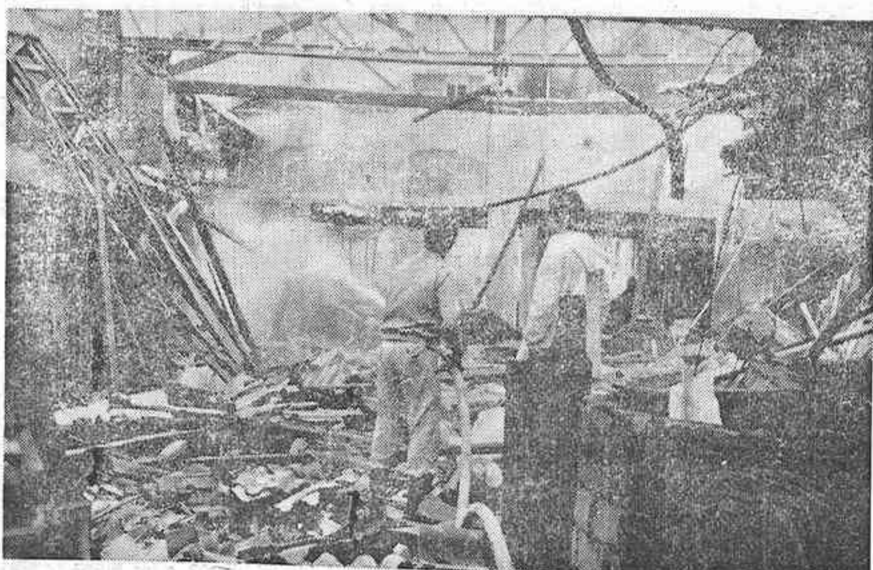
En la madrugada del sábado, se produjo un incendio en la discoteca «Player», de Almazora. Las llamas, que tomaron incremento con asombrosa rapidez, destruyeron totalmente el inmueble situado en la calle General Franco. La intervención de los bomberos de Castellón y efectivos municipales evitó que el fuego afectara también a los edificios colindantes. No hubo que lamentar desgracias personales, pero las pérdidas materiales son cuantiosas. — (Foto: HEREDIO).
