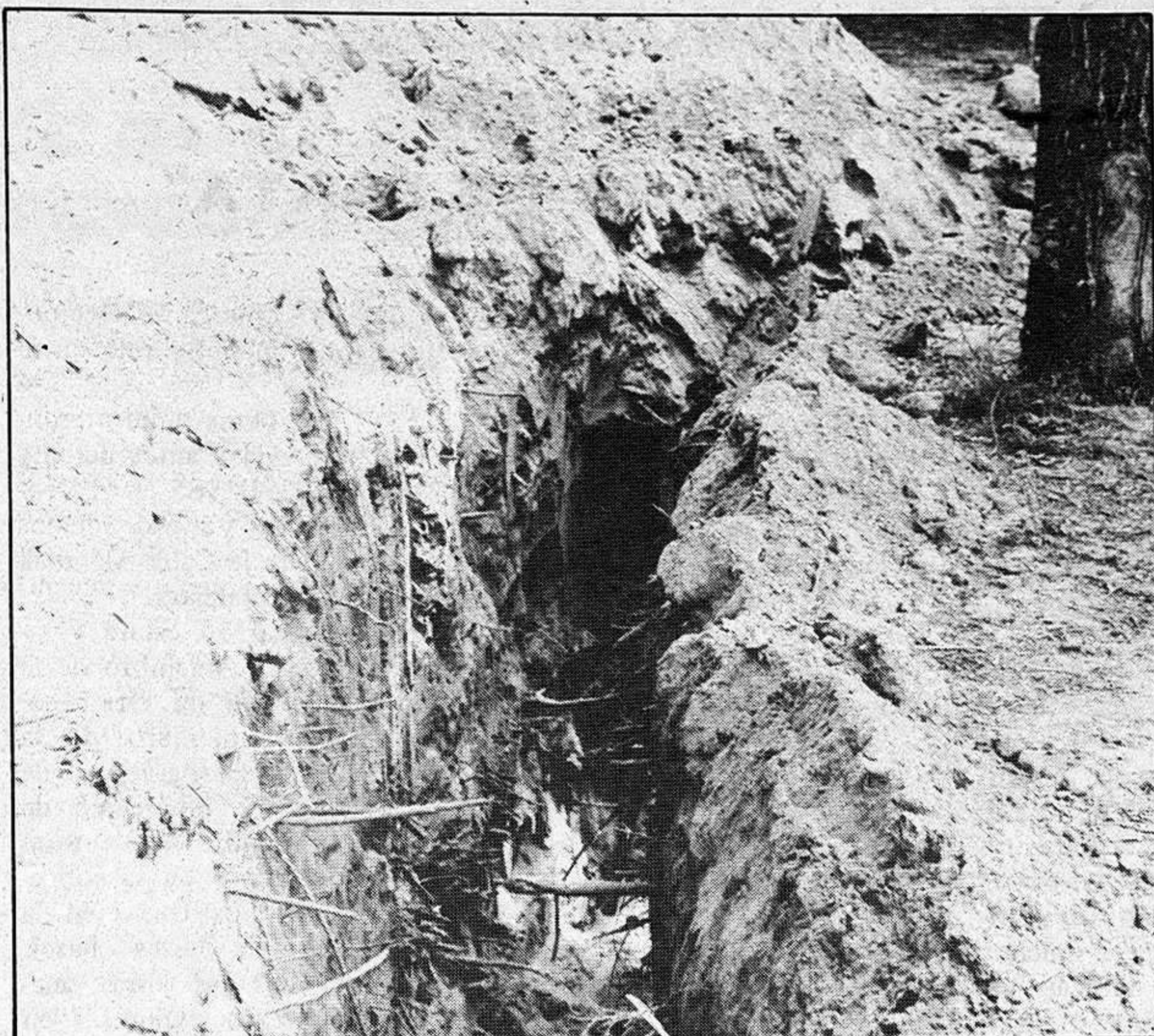
Cuando la actuación se efectuó en olmos que estén rodeados de otros, hay que cavar un foso para evitar el contacto de las raíces
