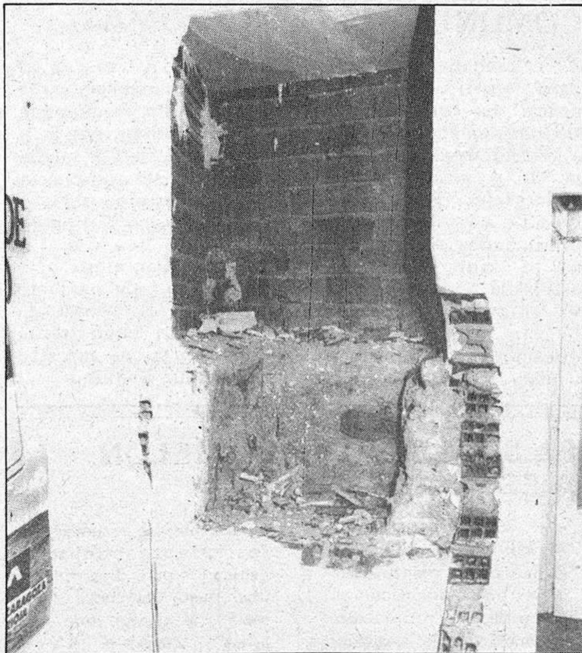
La caja fuerte fue arrancada de esta pared con la ayuda de un gato hidráulico
