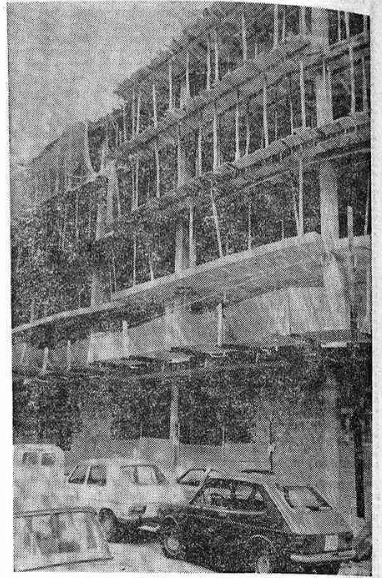
Las mallas protectoras se han impuesto como elementos de seguridad en el proceso de construcción de edificios
