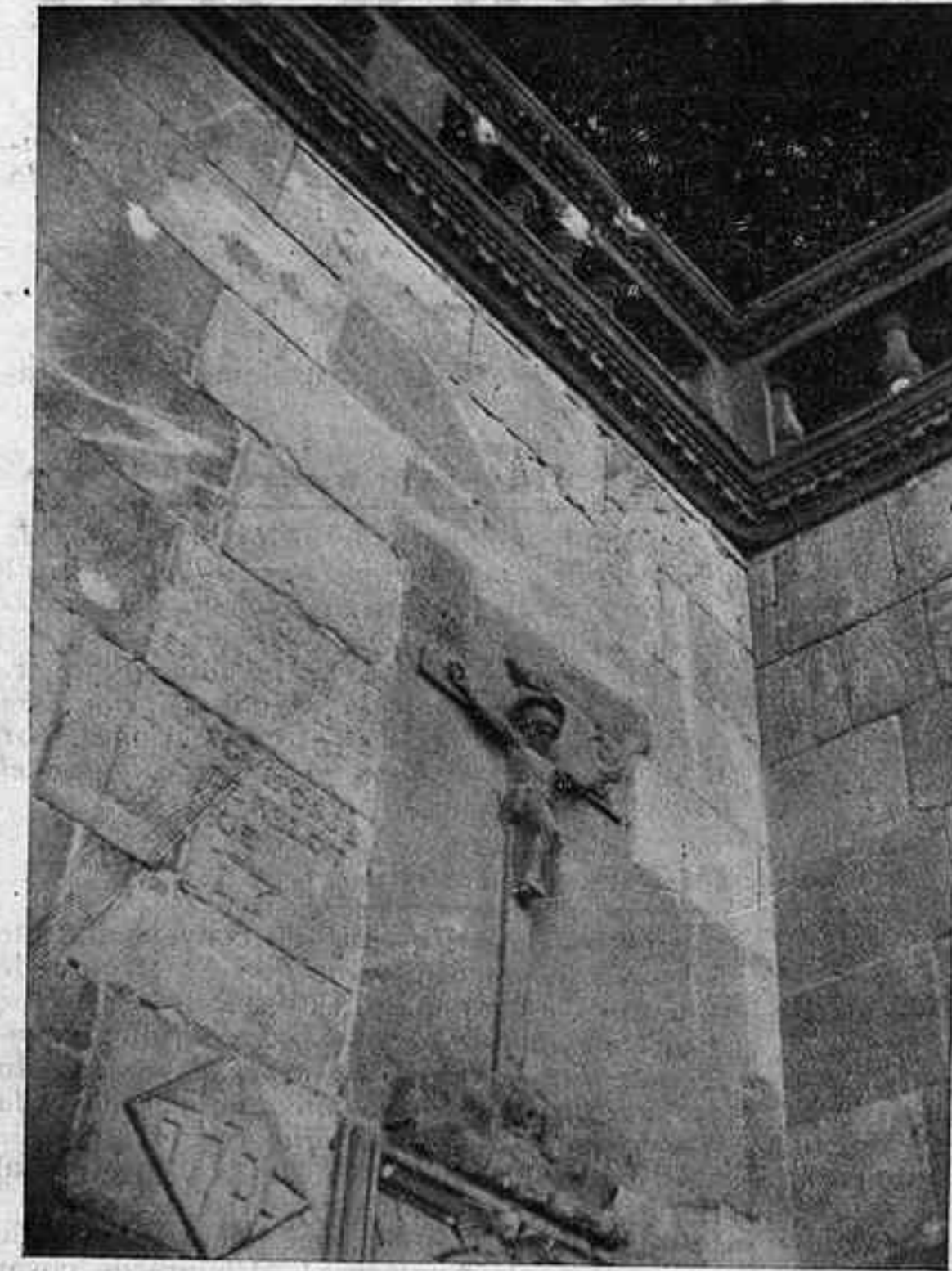
Sobre l'entrada a la cambra del rellotge, els impactes (taques blanques) del 6 d'octubre
