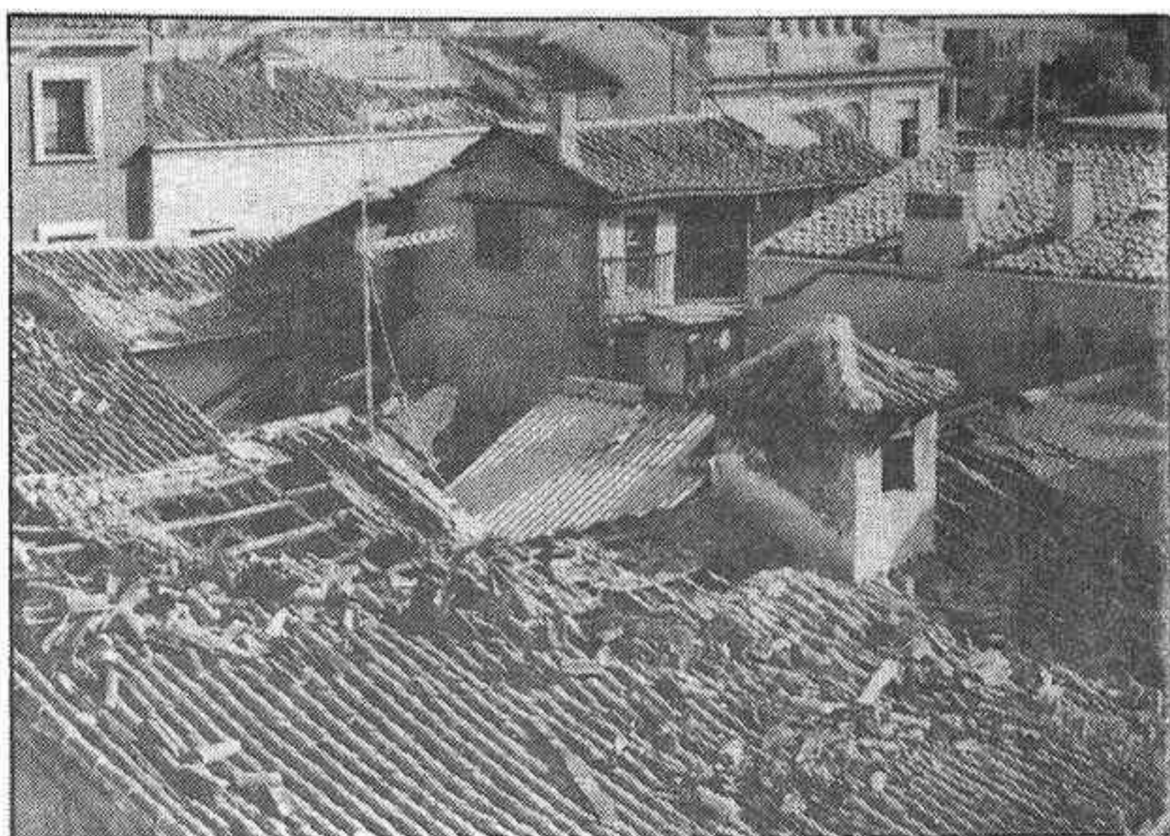
El fuego empezó en la parte central de la fotografía, propagándose a las dependencias colindantes. Los bomberos tuvieron que romper el tejado
