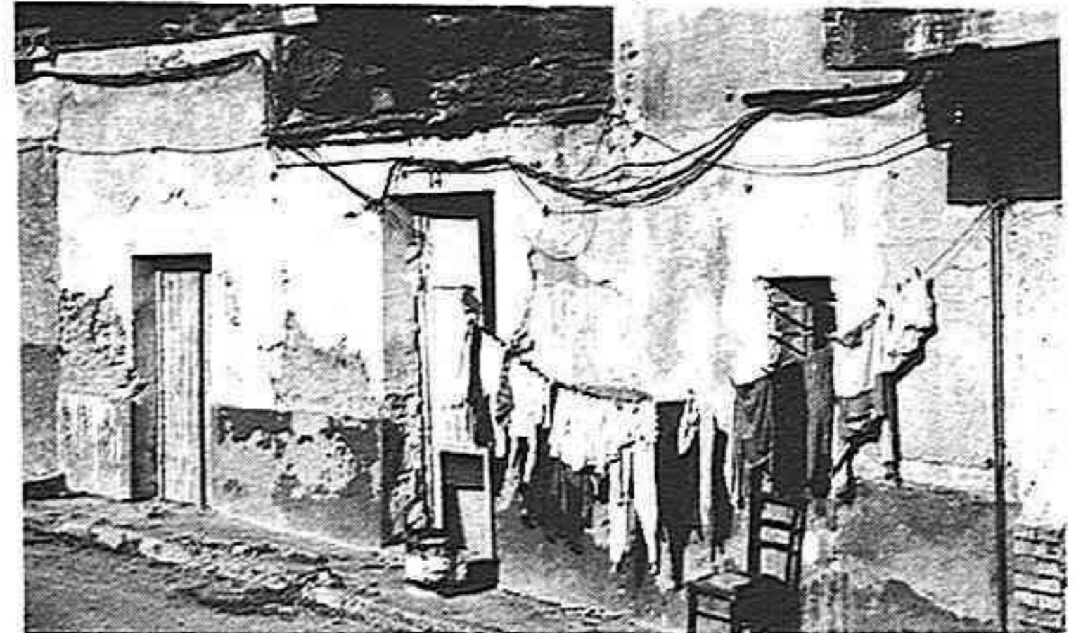
Nº 2. Bº San Antón. C/ San Antón. Grupo de viviendas en estado ruinoso sin agua potable y sin luz. En el invierno no se puede vivir en ellas.
