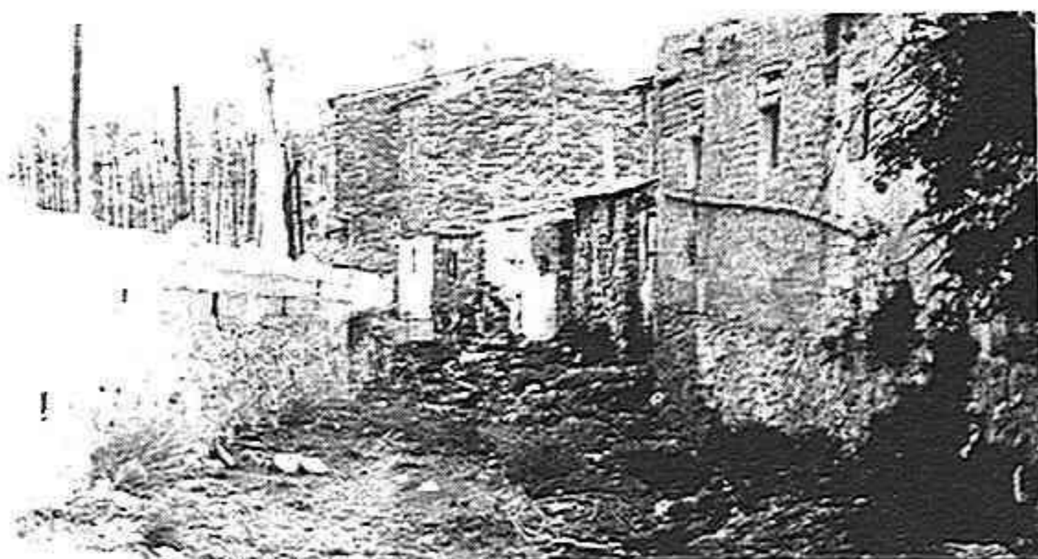
Nº 5.- Bº San Antón. C/ Espalda San Antón, que da al barranco lleno de basuras y de ratas.
