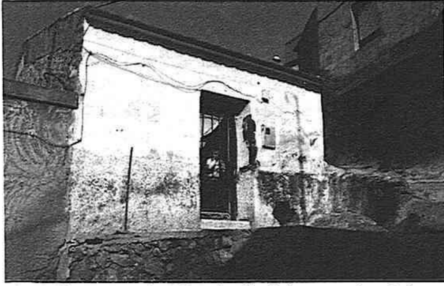
Nº15.- En esta casa viven 7 de familia sin ingresos, sin trabajo. Duermen todos en una sola habitación. La humedad derribó la pared del techo.
