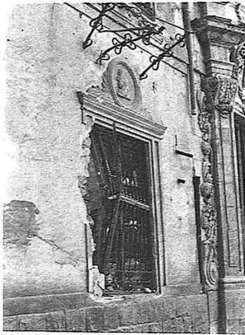
Foto N°6 Las rejas de la planta baja y las ménsulas de los balcones retorcidas y quebrantadas.
