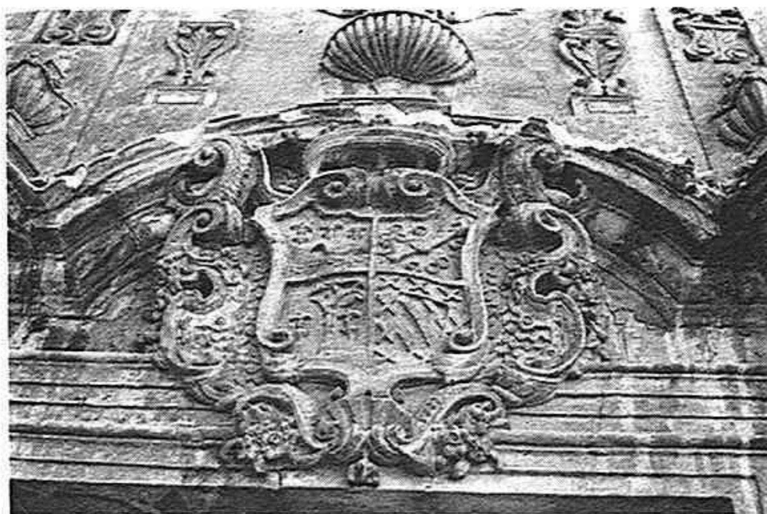
Foto Nº5 Tímpano heráldico de la Portada barroca la cornisa está rota por la demolición.
