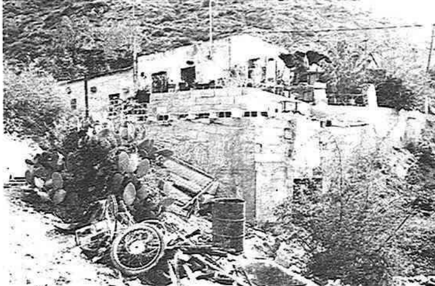
Nº11.- Intento de construir su propia vivienda junto al barranco en la subida a Las Canteras. Intento abandonado. Al fondo, las últimas casas de la calle. Bº San Antón.
