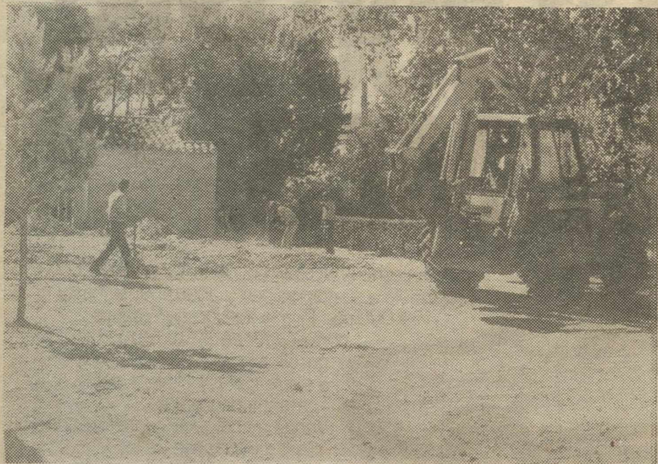
Los solares de las antiguas casas de los funcionarios están siendo explanados para convertirse en zonas verdes.
