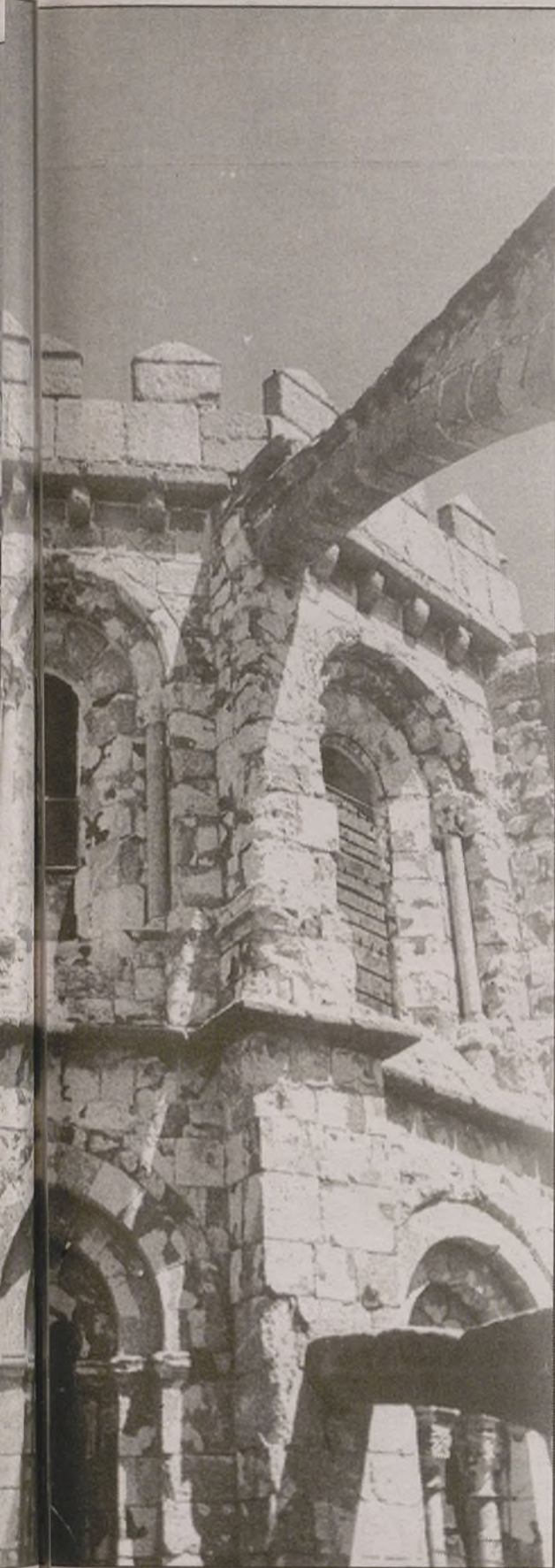
El ábside de la catedral de Ávila está seriamente afectado por el mal de la piedra y reclama una urgente atención. El hecho de ser piedra arenisca agrava la situación, ya que el factor climático se convierte en uno de los principales agentes destructivos. Del mismo modo, el pórtico de los Apóstoles y la entrada oeste de San Vicente sufren la enfermedad sin que se haya puesto hasta ahora remedio alguno. La madera de los objetos que se conservan en el interior de los templos también se ven afectados por el factor medioambiental y el ataque de la carcoma.
