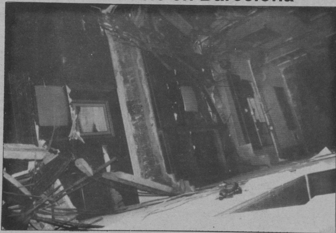
Interior del inmueble cuyo desplome ha ocasionado un muerto y dos heridos
