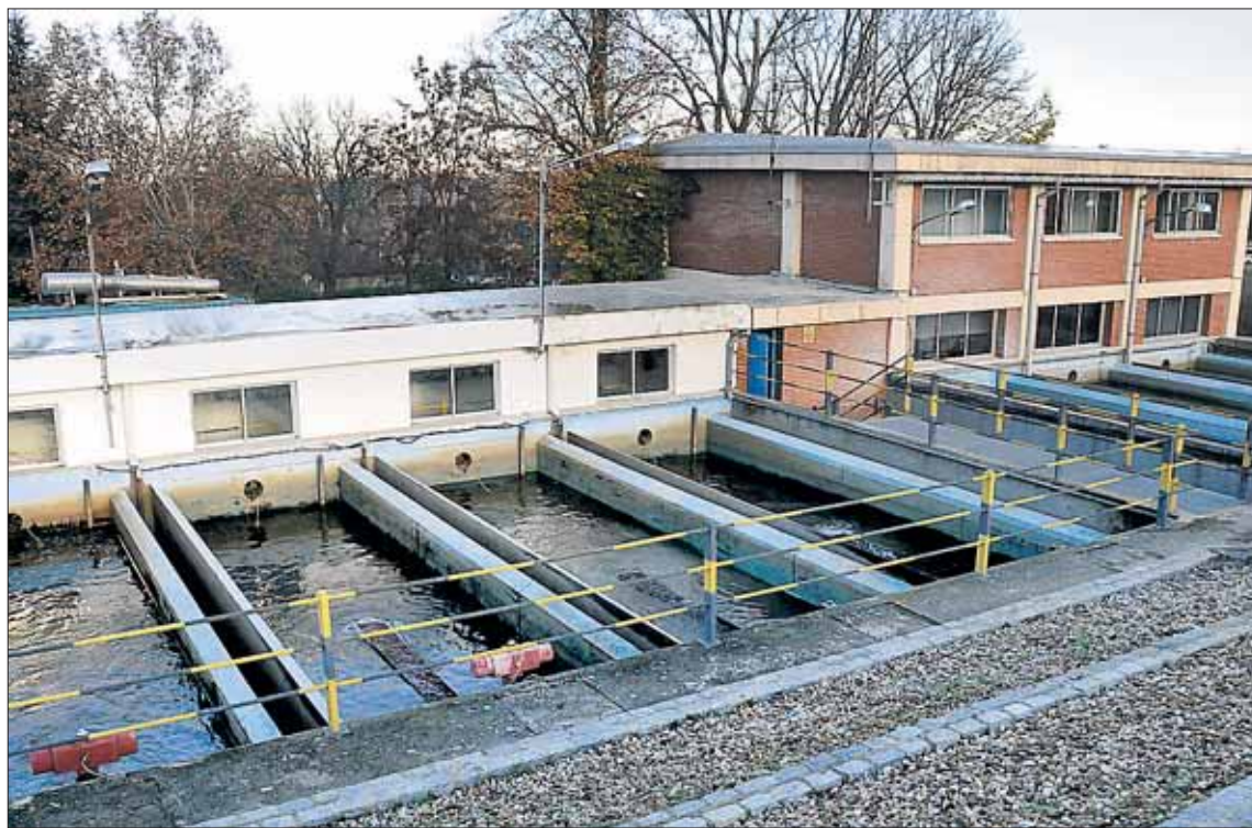
Imagen de la estación potabilizadora, situada en la avenida de Juan de Borbón. / JUAN MARTÍN
