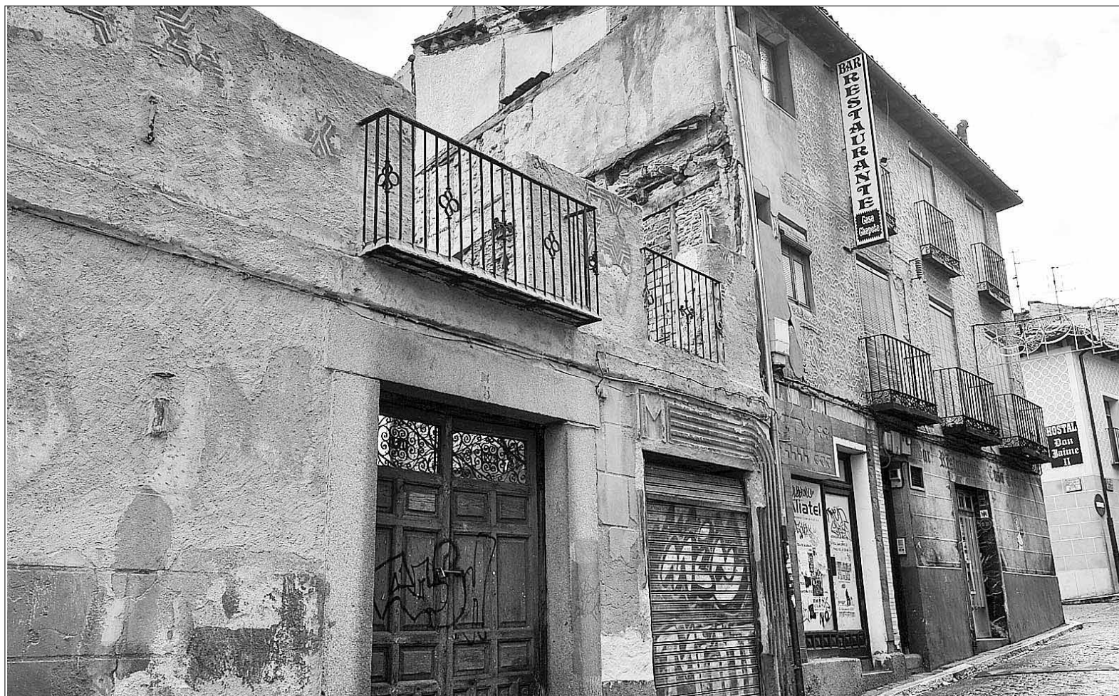
En el barrio existen edificios singulares, como el de la imagen, en la calle Ochoa Ondátegui, que se encuentran en estado de ruina. / KAMARERO
