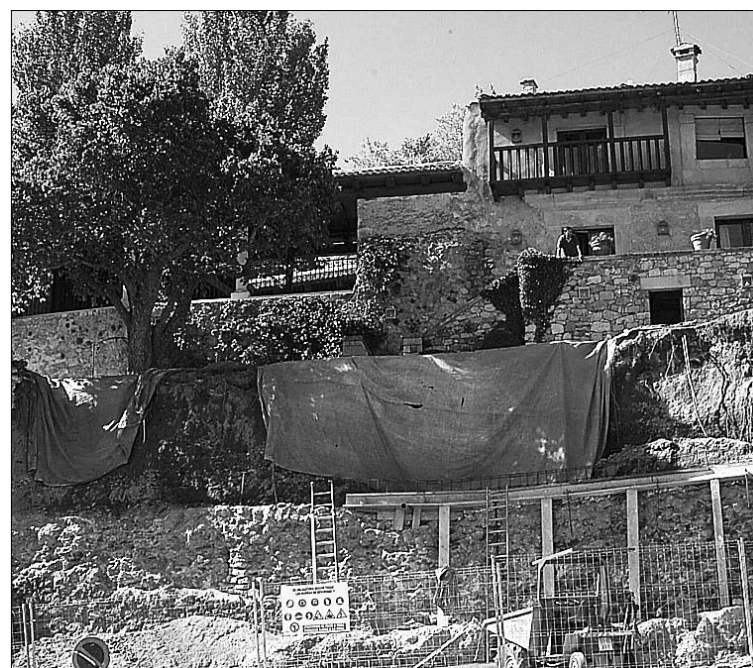
La muralla de Pedraza sufrió un importante desplome hace unos meses. /G.H.
