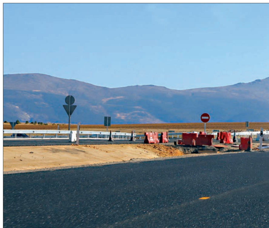
Estado de las obras de la futura autovía Valladolid-Segovia, que aborda la Junta de Castilla y León
