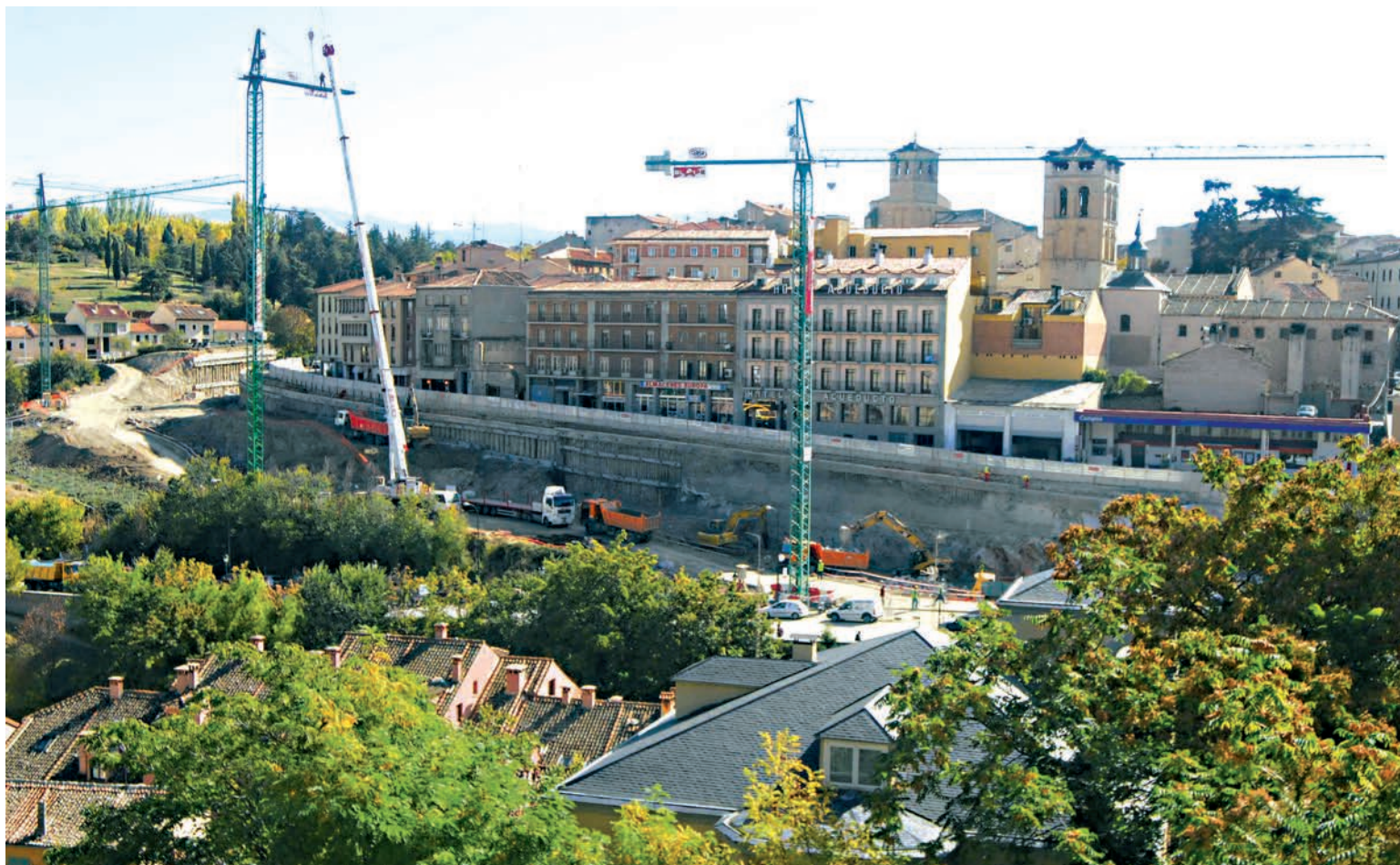
Han finalizado la mayor parte de las obras de excavación en el futuro aparcamiento de Padre Claret / KAMARERO
