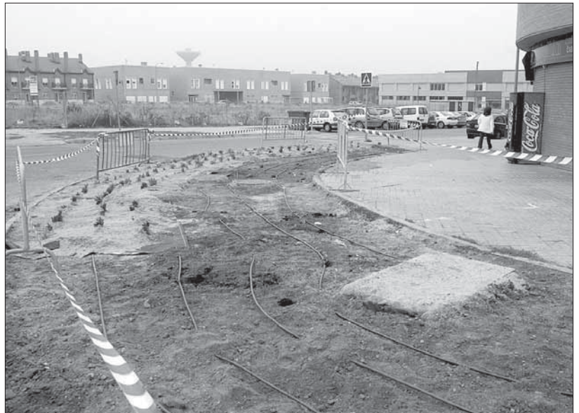
El municipio ha dotado de riego automático a dos espacios ubicados en Dámaso Alonso
