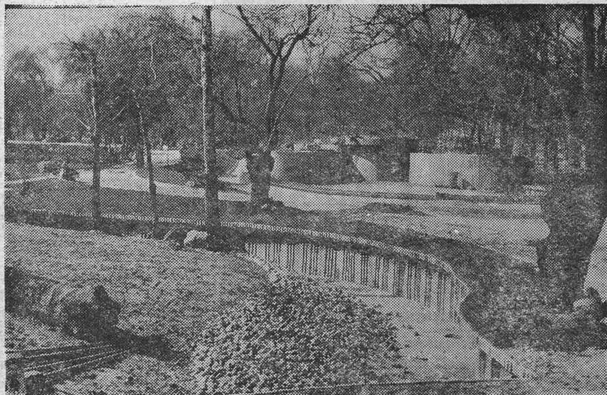
Están muy avanzadas las obras de construcción del nuevo parque zoológico de Madrid en la Casa de Campo. La inauguración está prevista para el mes de mayo. En la foto vemos el estado actual del nuevo zoo madrileño, que será uno de los más interesantes de Europa. (Foto Fiel.)
