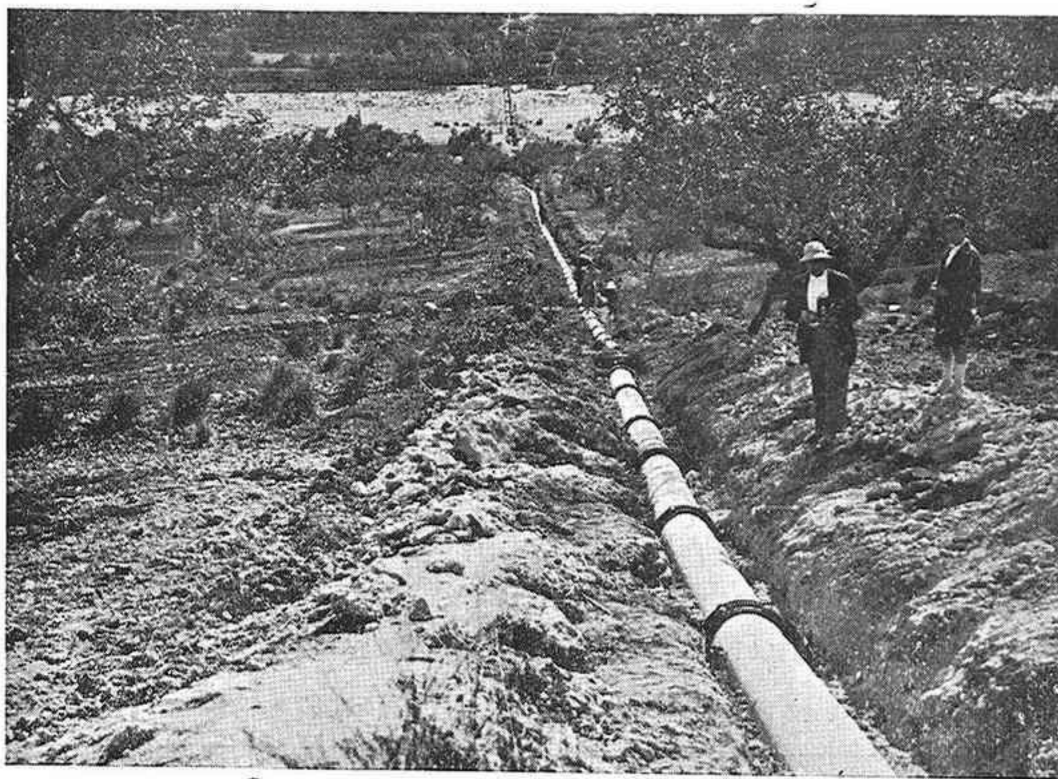
Tubería a presión URALITA, instalada por cuenta de la Compañía de Caminos de Hierro del Norte.
