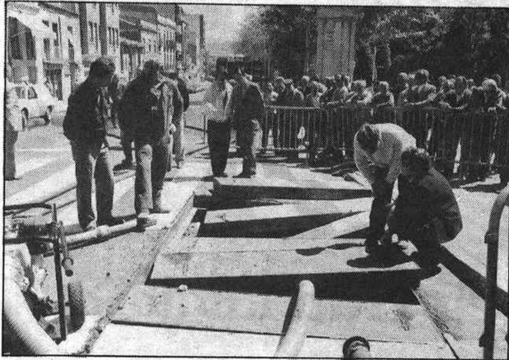
VALENZUELA El Alcalde recibe explicaciones de lo ocurrido tras producirse el reventón que levantó las traviesas de la calle.
