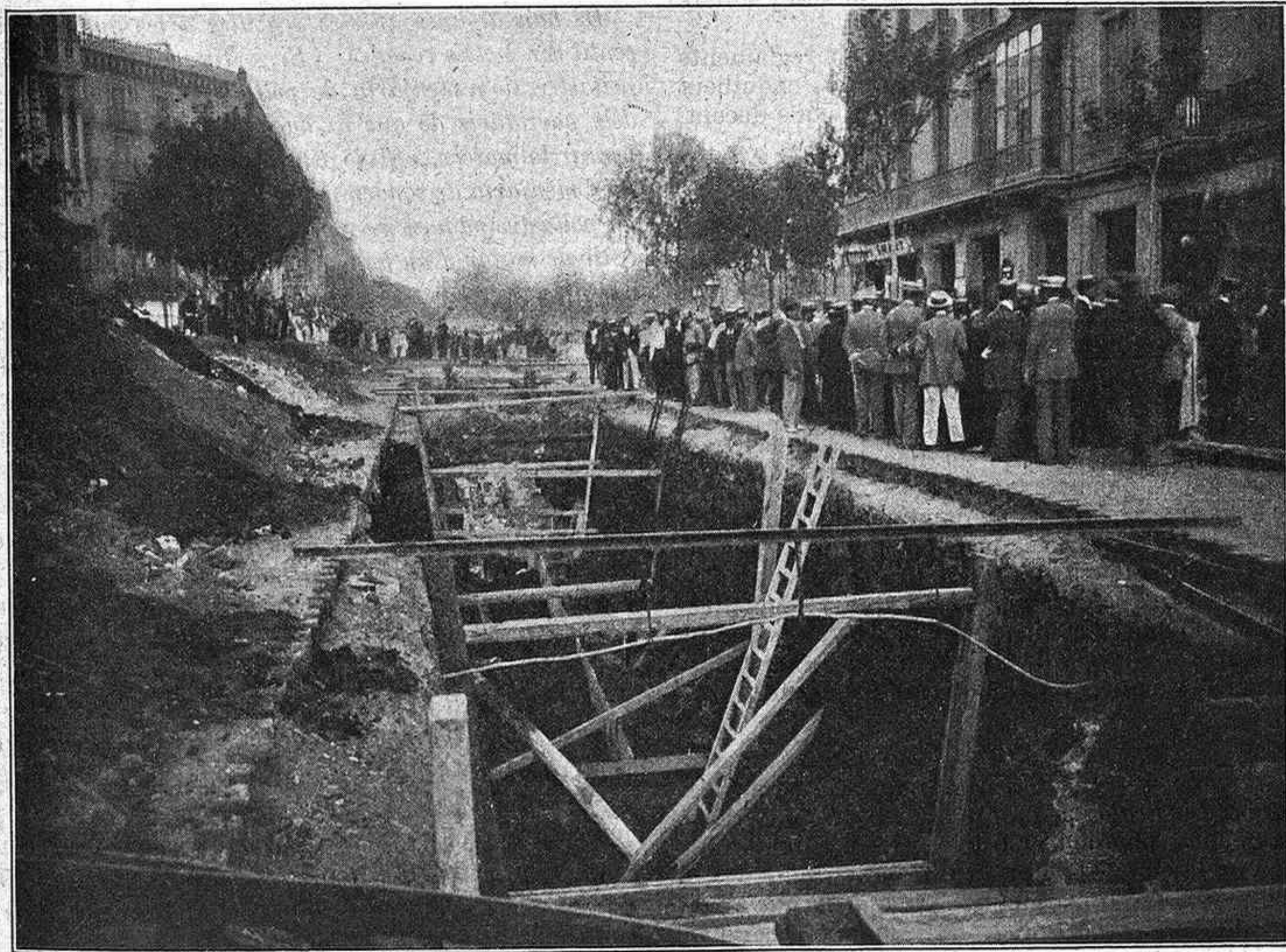
Excavacions pera la cloaca de la Ronda de la Universitat, ahont el passat dissapte ocorregué el desprendiment de terras del que 'n resultaren un treballador mort y varis gravement ferits.
