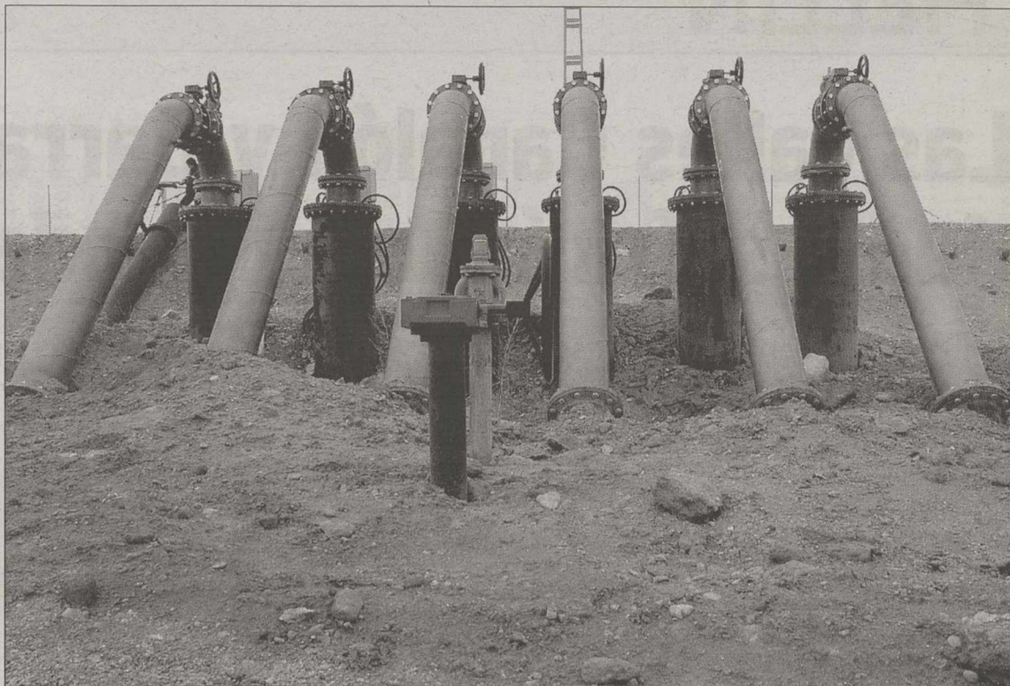
Instalaciones de bombeo. / ARTURO PÉREZ
