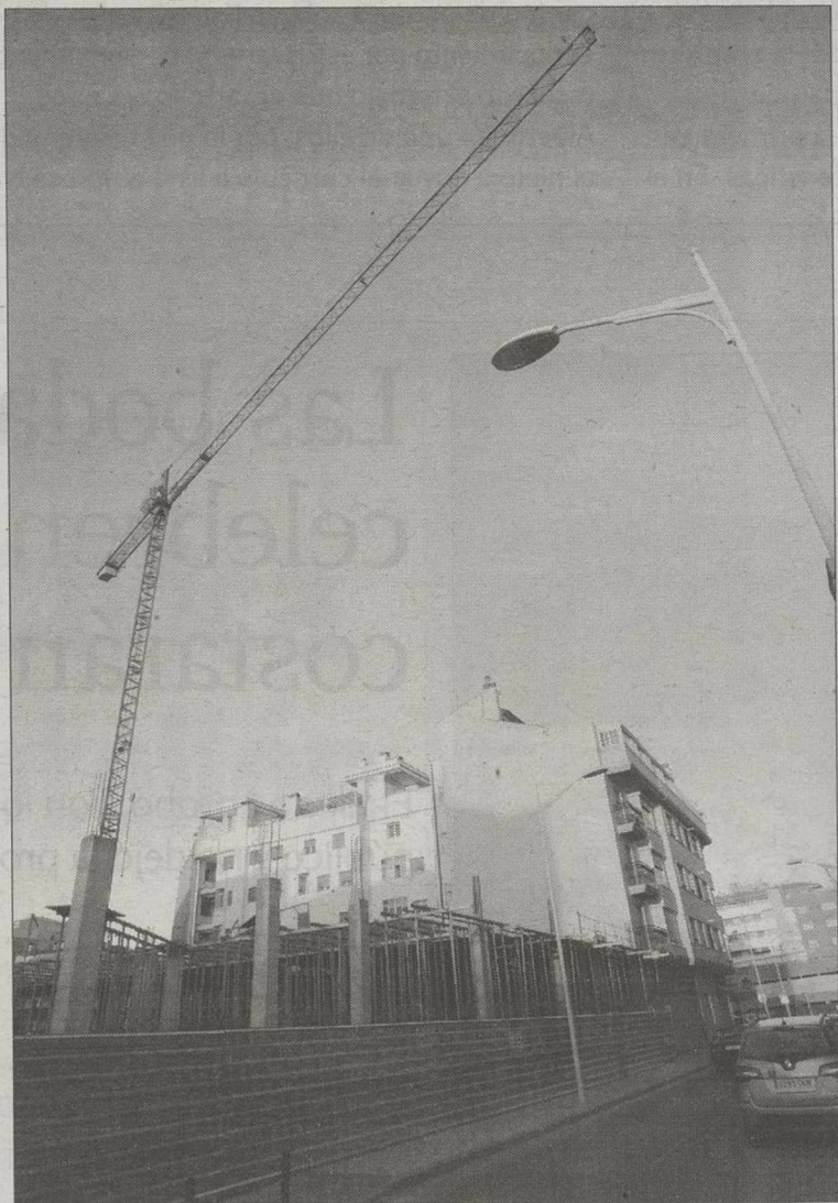
Imagen de archivo de una obra, con un bloque de viviendas al fondo. / R. SERNA
