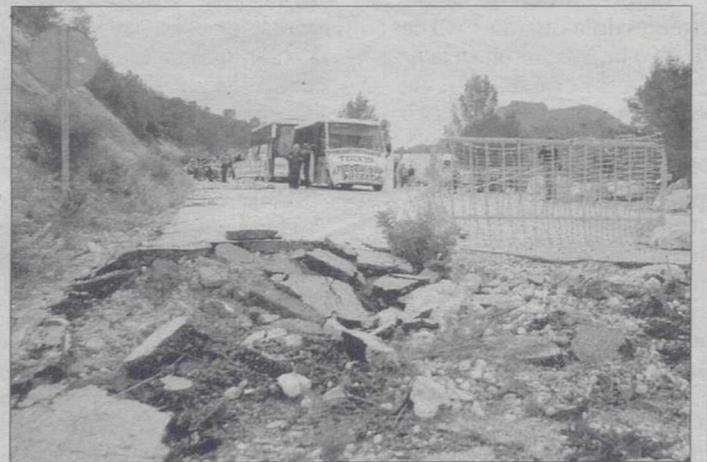
Estado actual de uno de los tramos de la carretera. / R. SERRALLÉ
