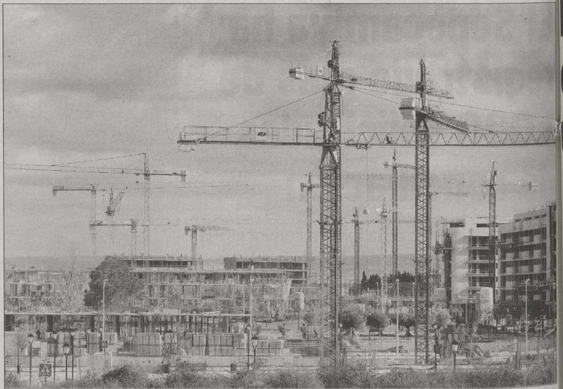
Vista panorámica de varios edificios en construcción en la capital albaceteña. / CONSUELO LÓPEZ
