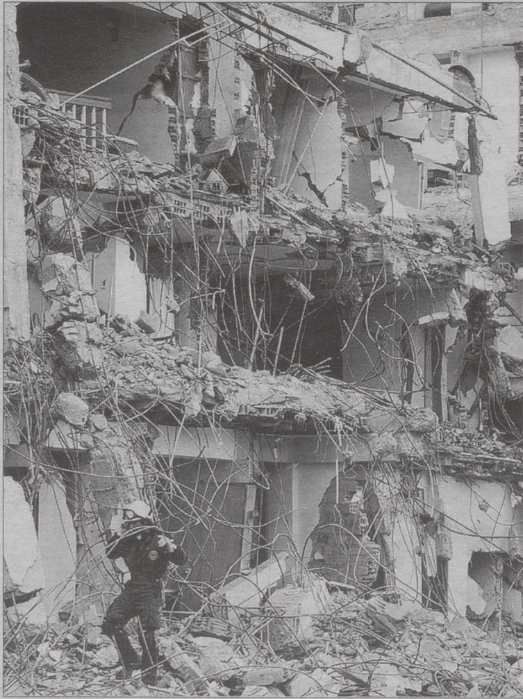
La mayoría de los edificios no aguantaron el devastador temblor. / EFE
