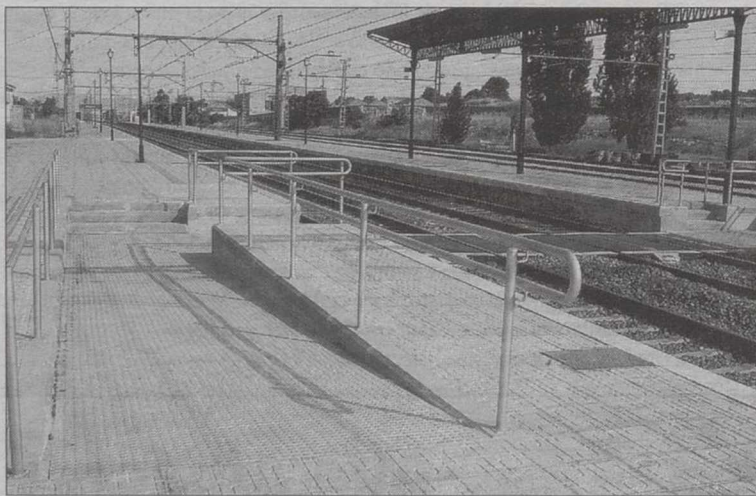
Vista de las nuevas rampas para acceso a los trenes. / LUIS BONETE
