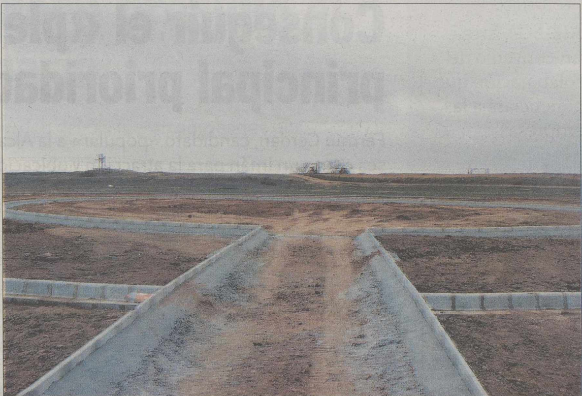
Aspecto que presentan las obras de esta nueva infraestructura situada en el Polígono «El Salvador»./LAMORA
