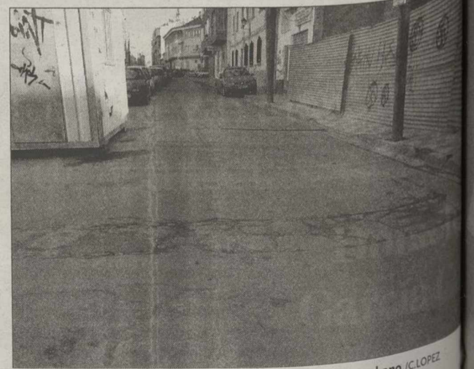
Hay problemas en el asfaltado y se carece de mobiliario urbano. /C. LOPEZ
