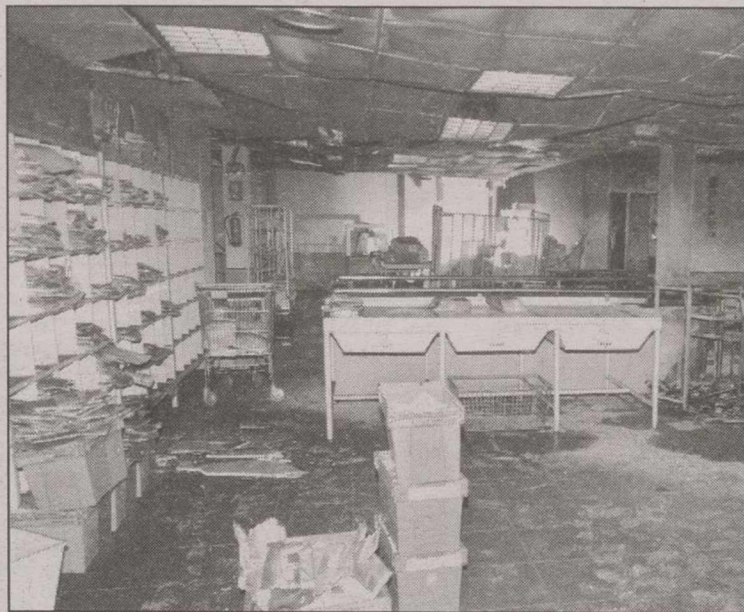
Interior de las nuevas oficinas de Correos atacadas.
