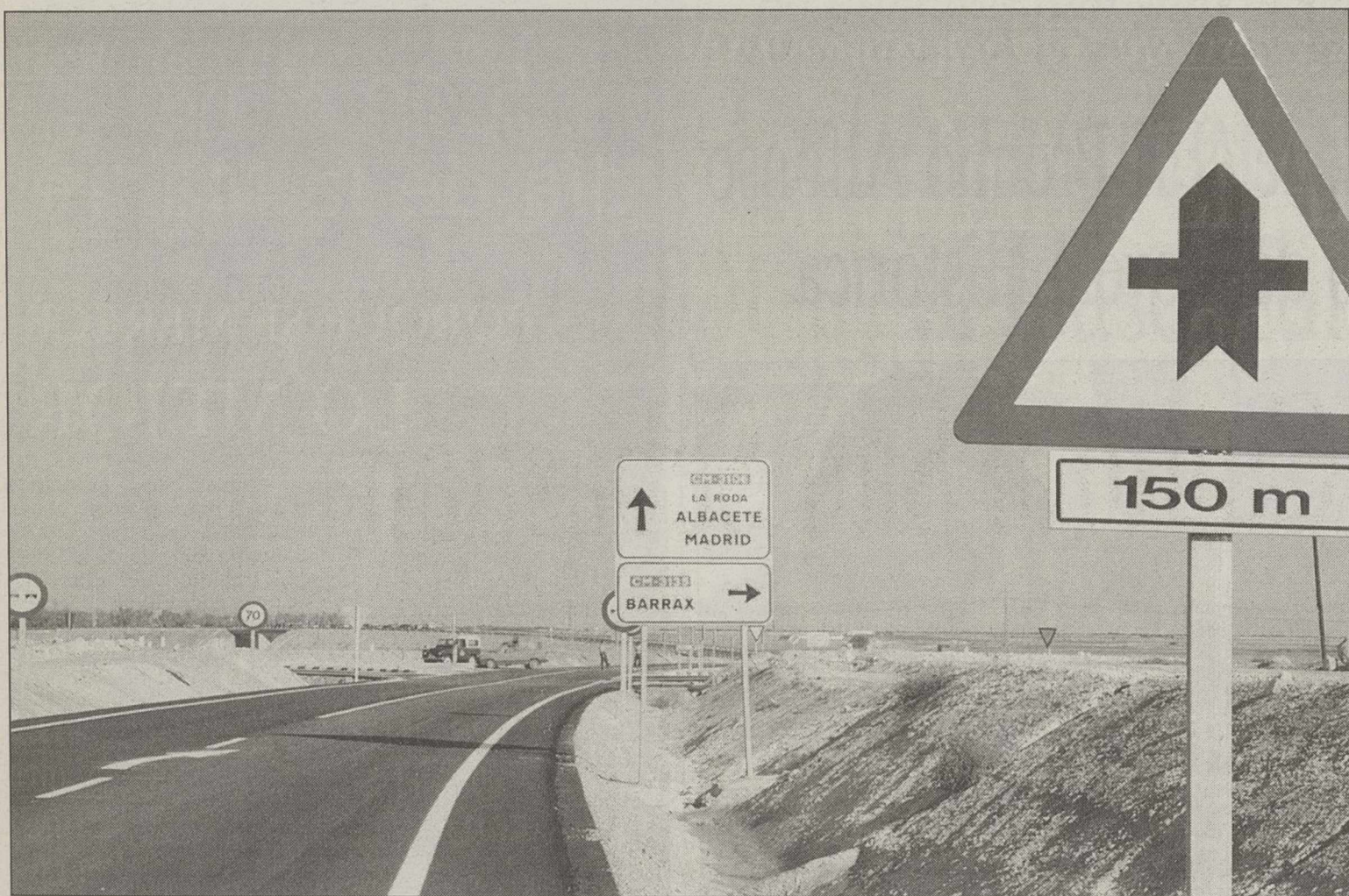
El consejero de Obras Públicas, Alejandro Gil, visitó ayer las obras de acondicionamiento en dos carreteras de la provincia. J.L.
