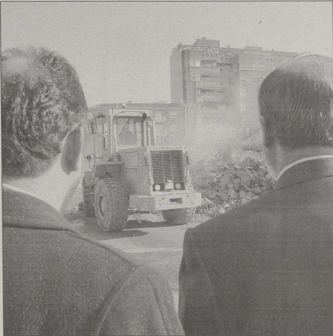
La vivienda demolida ya había ocasionado varios accidentes.
