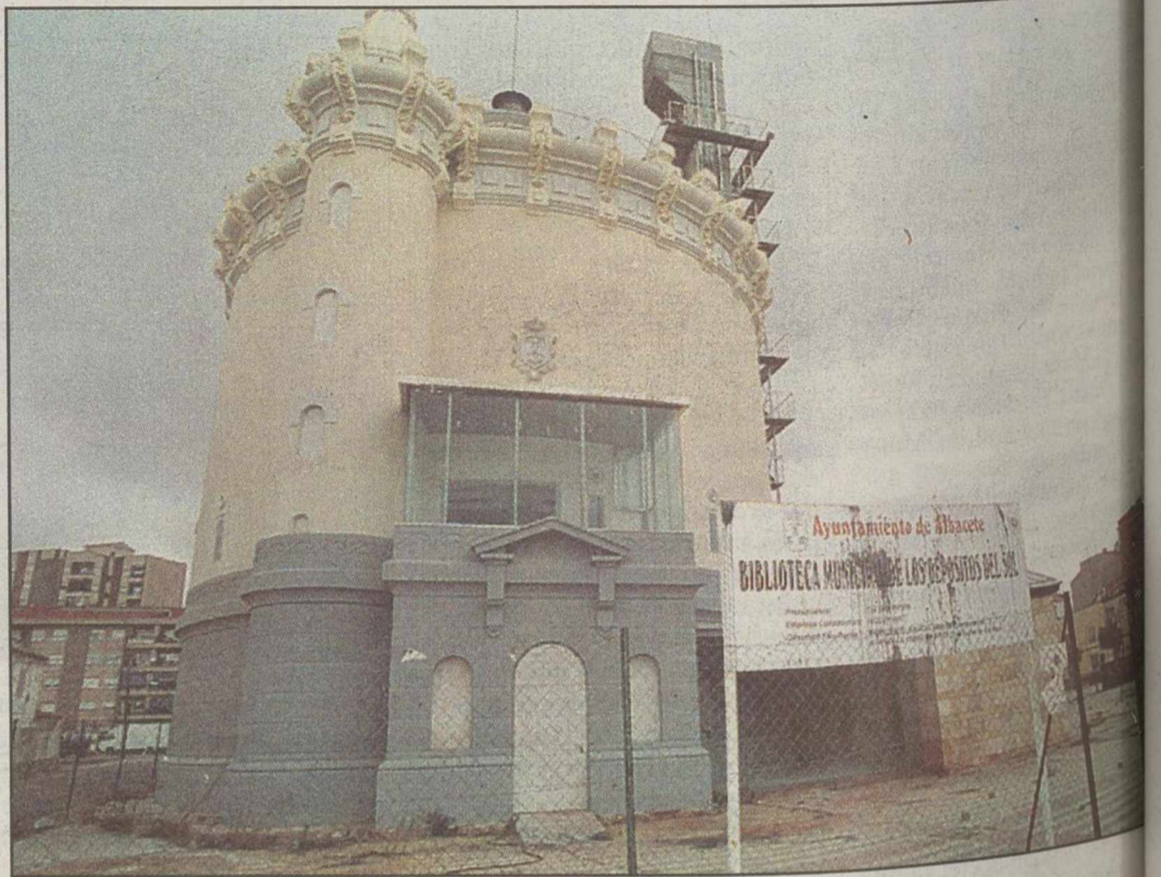
La empresa aún no ha terminado las obras de rehabilitación y acondicionamiento del Depósito del Sol.
