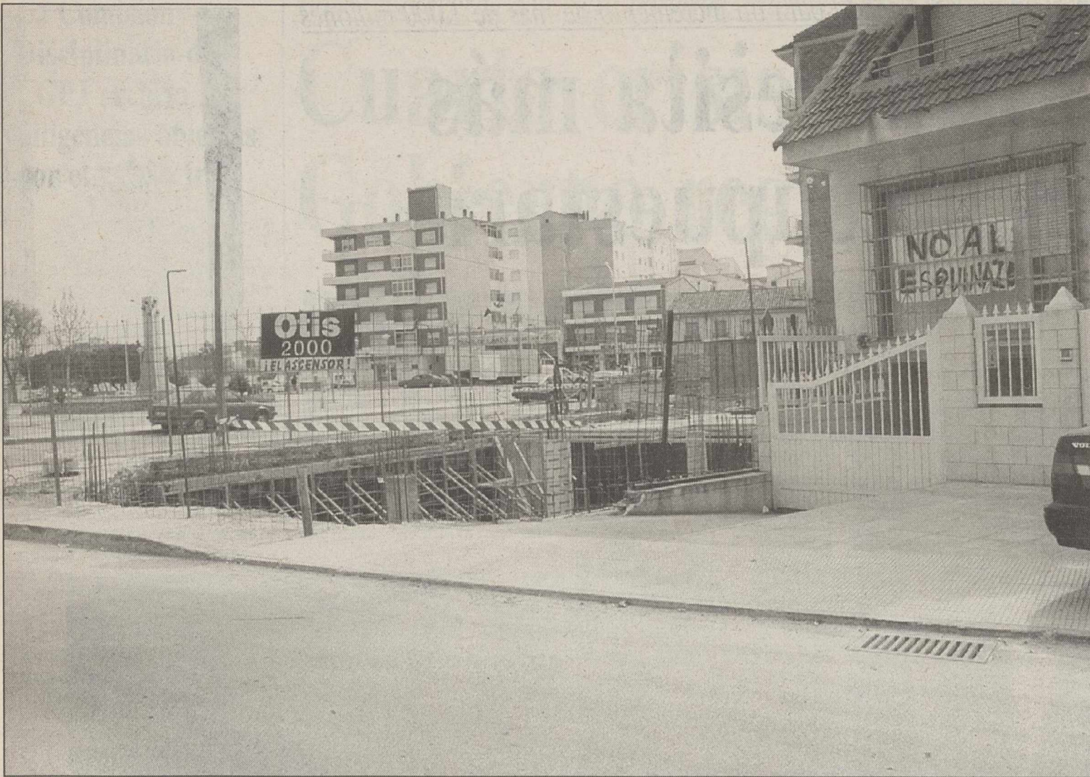
Aunque al Ayuntamiento le parece una barbaridad no puede hacer nada ya que técnicamente la construcción es legal.
