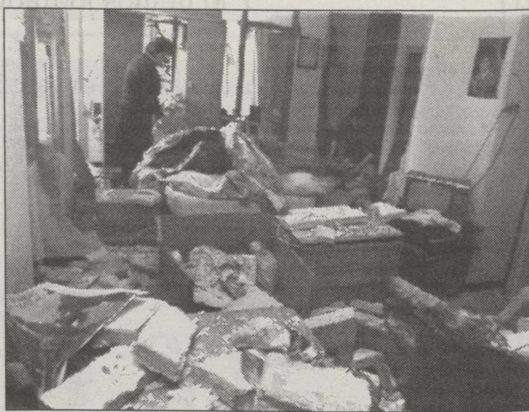
La vivienda del herido quedó en el estado que muestra la imagen.
