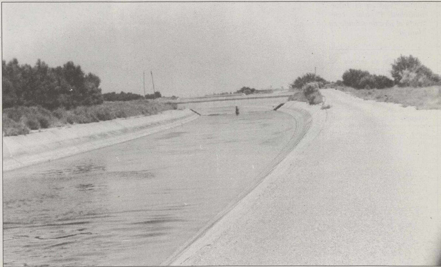
Aqueducto del trasvase Tajo-Segura a su paso por la provincia de Albacete.
