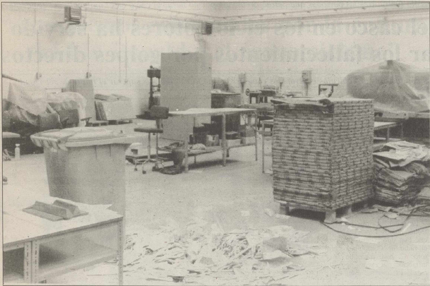
La nave donde está instalada la maquinaria de la Imprenta Provincial presenta un estado ruinoso y de deterioro.
