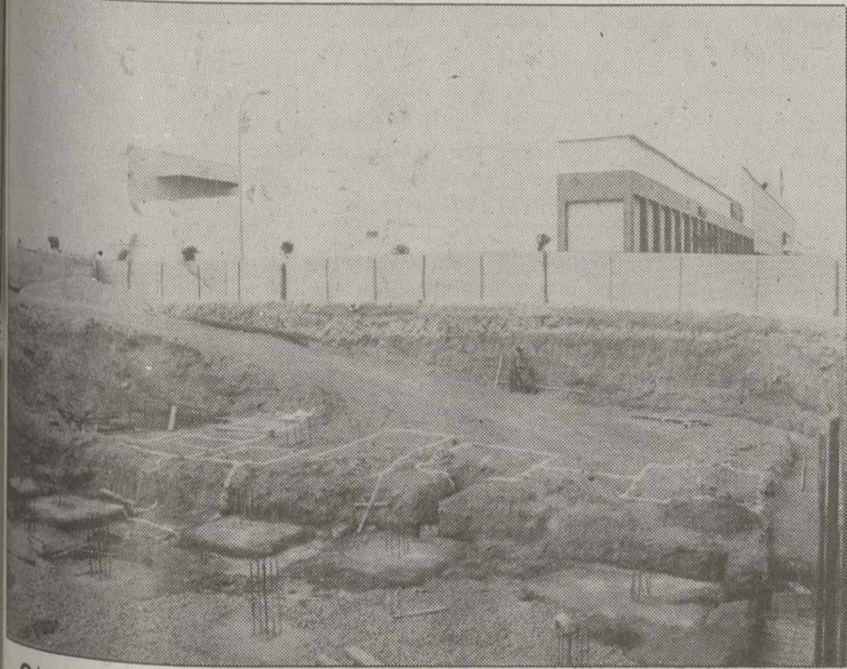
C/ G. MENDEZ PARADA ESQUINA FERNANDO POO 20 VIVIENDAS CON PLAZA DE GARAJE Y LOCALES.
