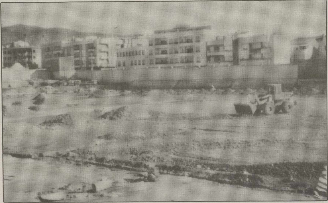
Las obras del Complejo Santa Ana, causantes del problema.
