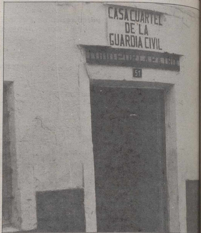
La actual casa-cuartel está en estado ruinoso.
