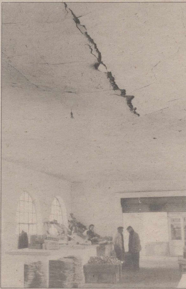
El techo está a punto de desplomarse.
