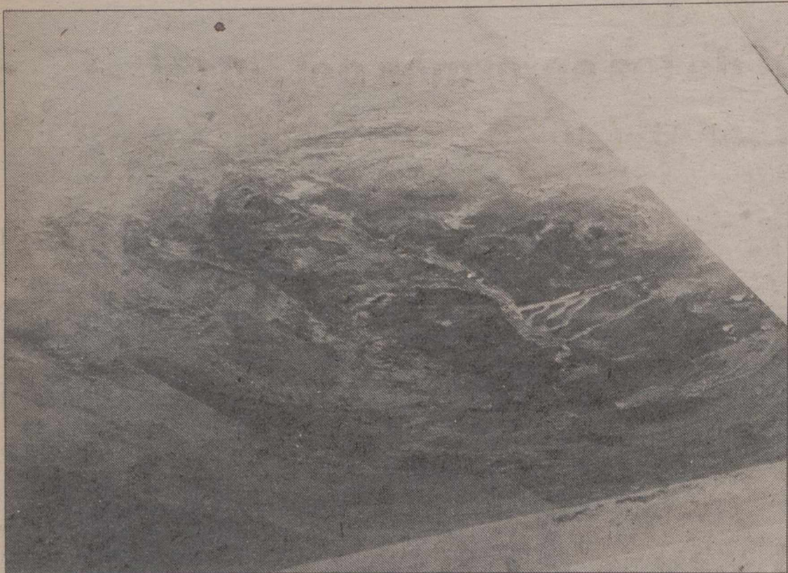
Una de las goteras en el techo de unos servicios amenazando hundimiento.
