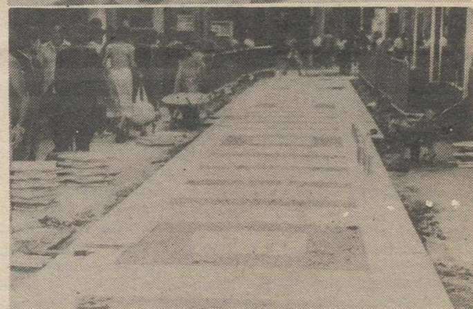
Tras haber llegado a un acuerdo Ayuntamiento y comerciantes de la calle Mayor, el pavimento continúa realizándose a buen ritmo. Al final, el diseño y las grescas no van a quedar nada mal. La mejora es evidente.—(Fotos Luis Miguel).
