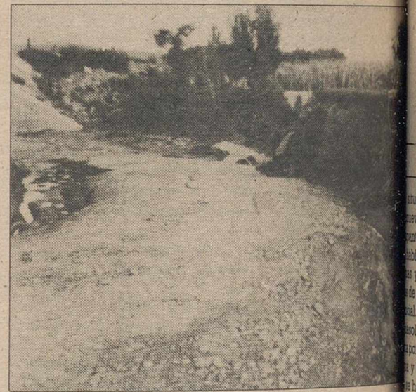
La rambla de encauzamiento, destrozada por la riada.
