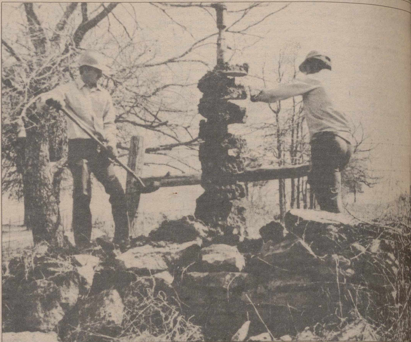
Las taladradoras mecánicas actúan en una colina situada al noroeste de Arkansas mientras los trabajadores se preparan para instalar un nuevo poste cerca de Hogeye. En este terreno pedregoso, la Ozarks Electric Cooperative distribuye el trabajo entre sus treinta y un miembros a lo largo de 4.810 millas de terreno.
