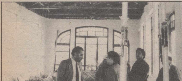
La techumbre del pabellón de la capilla ofrece, al descubierto, un aspecto preocupante; en primer plano pueden verse los refuerzos con que han sido apuntaladas las vigas en peor estado.
