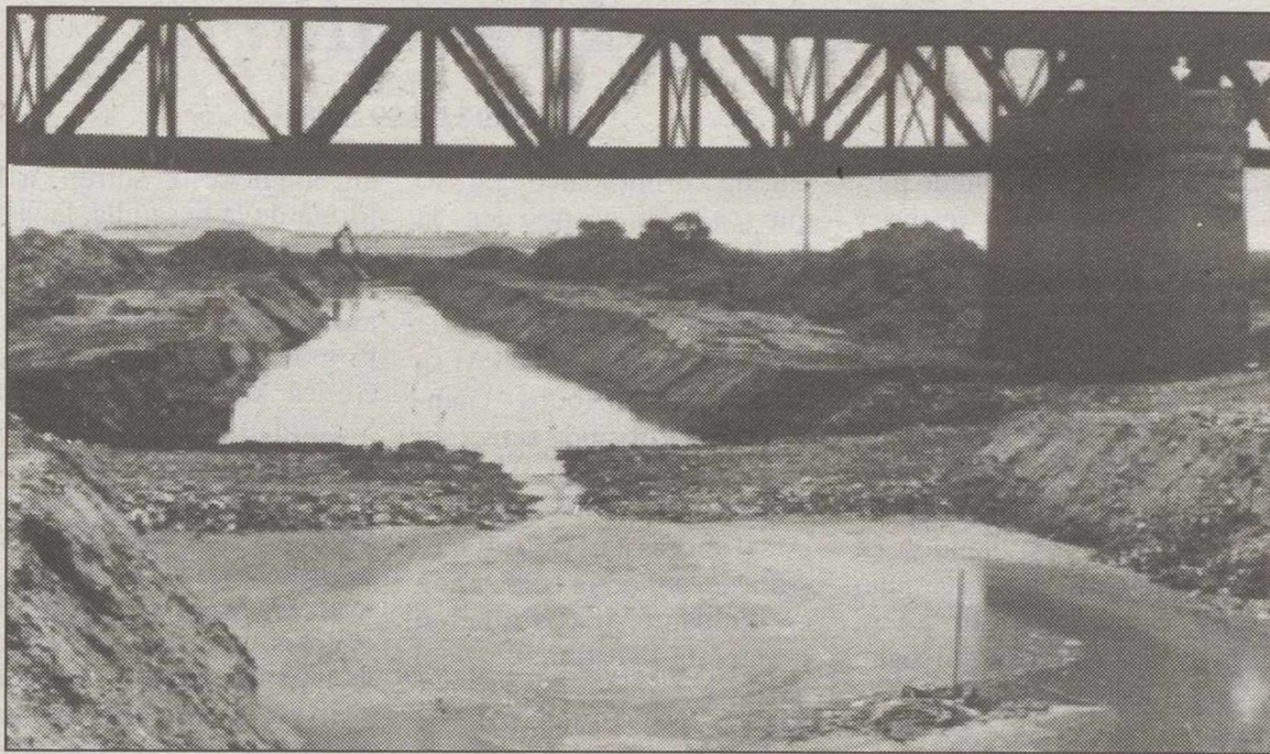
Las máquinas han destruido el cauce del río.
